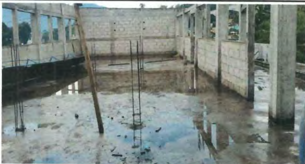
Foto 5: Aulas y corredor sin piso cerámico
