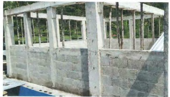
Foto 2: Laboratorio de computación sin puerta de doble hoja
