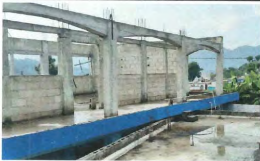
Foto 3: Salones del segundo nivel sin ventanas
