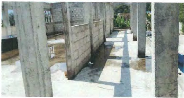
Foto1: Aulas sin puertas
